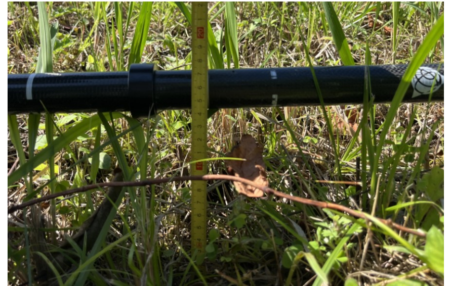
大京原の堤防の沈下 (14cmほど沈下)
